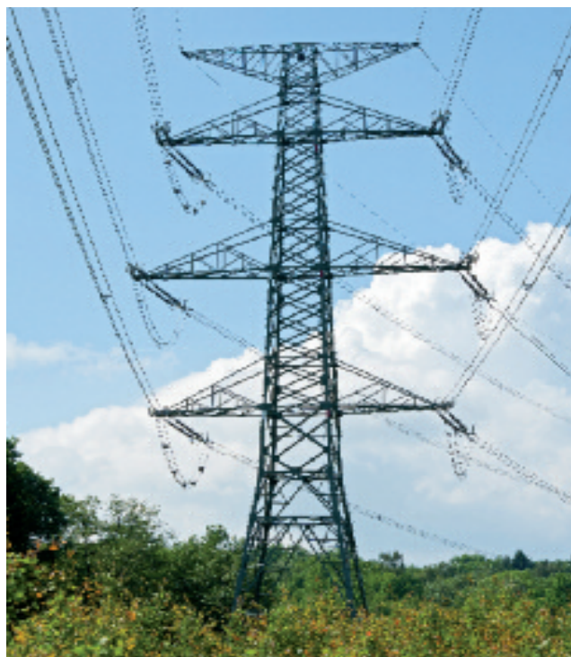
Soudek - kotevní (2x400 kV) Barrel tower - Anchor tower (2x400kV)
