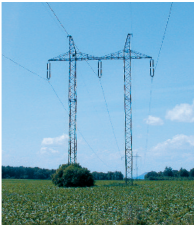
Portál - nosný Portal tower - Suspension tower
