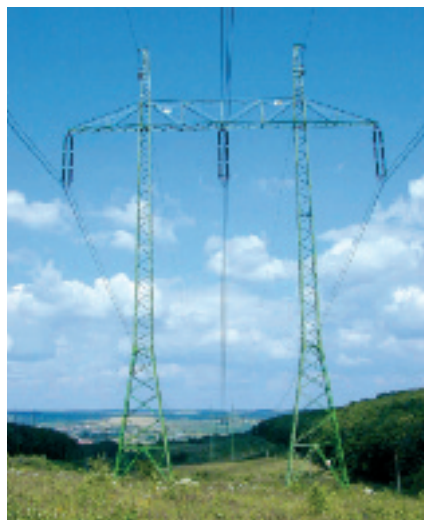
Portál - nosný Portal tower - Suspension tower
