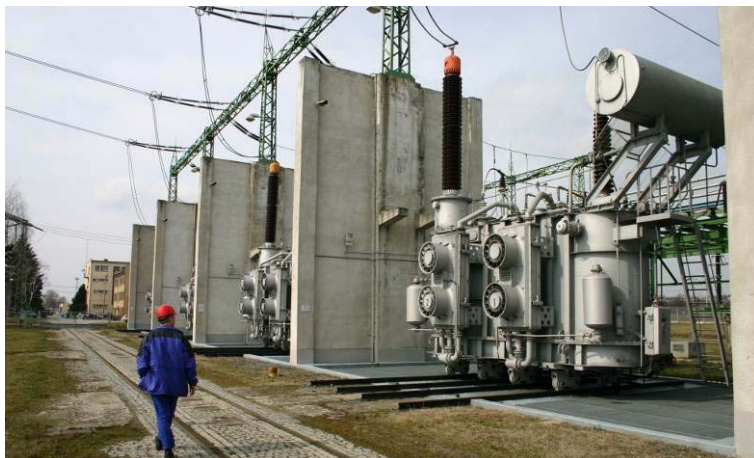
Obr. 21: Systémový transformátor složený z jednofázových jednotek
