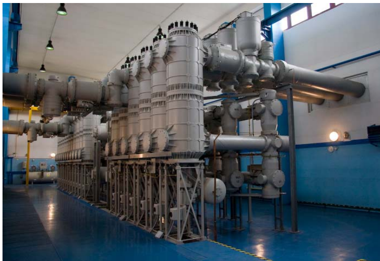
Obr.3: Zapouzdřená rozvodna Chodov 400 kV
