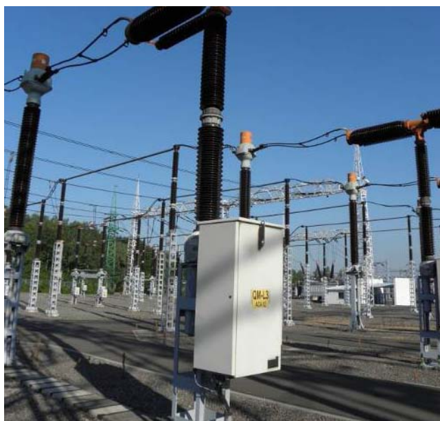
Obr. 13: Výkonový vypínač – fáze L3
