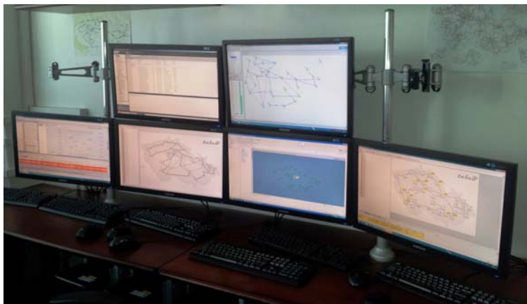
Obr. 6: Dohledové pracoviště telekomunikační sítě ČEPS
