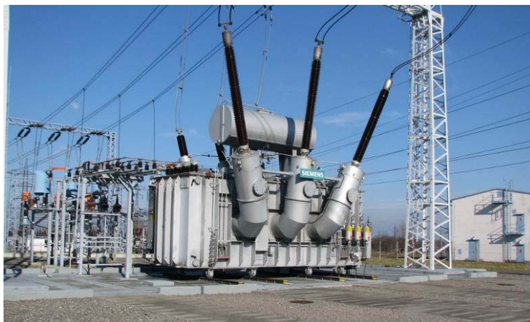
Obr. 22: Třífázový systémový transformátor
