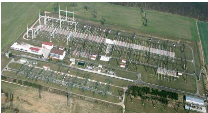
Obr. 1: Rozvodna přenosové soustavy
