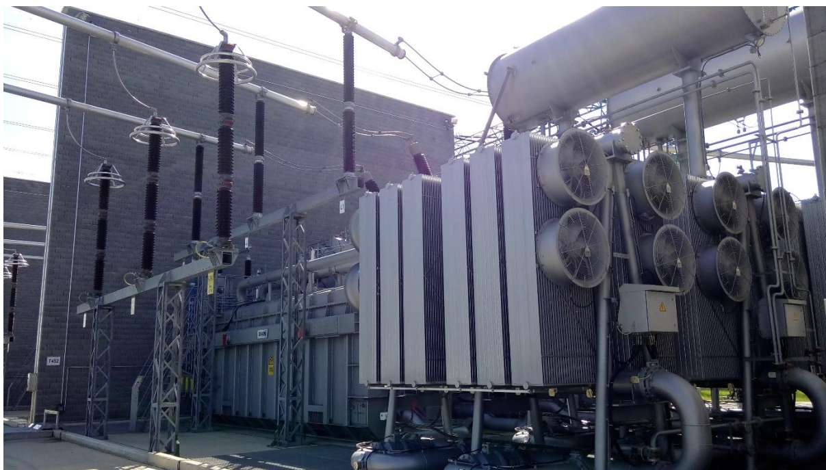
Jiný pohled na jednu fázi transformátoru s příčnou regulací
