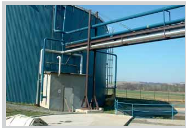
Bioplynová stanice se často využívá pro zvýšení energetické soběstačnosti obce. Foto: Jiří Beranovský, EkoWATT
