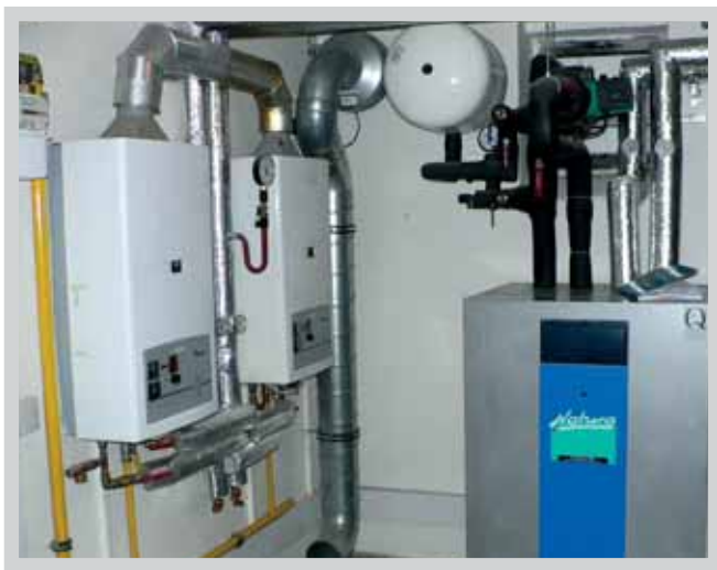
Tepelné čerpadlo pro vytápění bytového domu teplem z hlubinných vrtů. Foto: Karel Srdečný, EkoWATT
