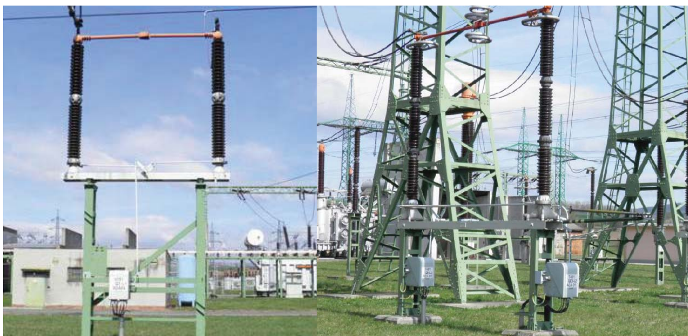
Obr. 15a: Odpojovač 220 kV.
