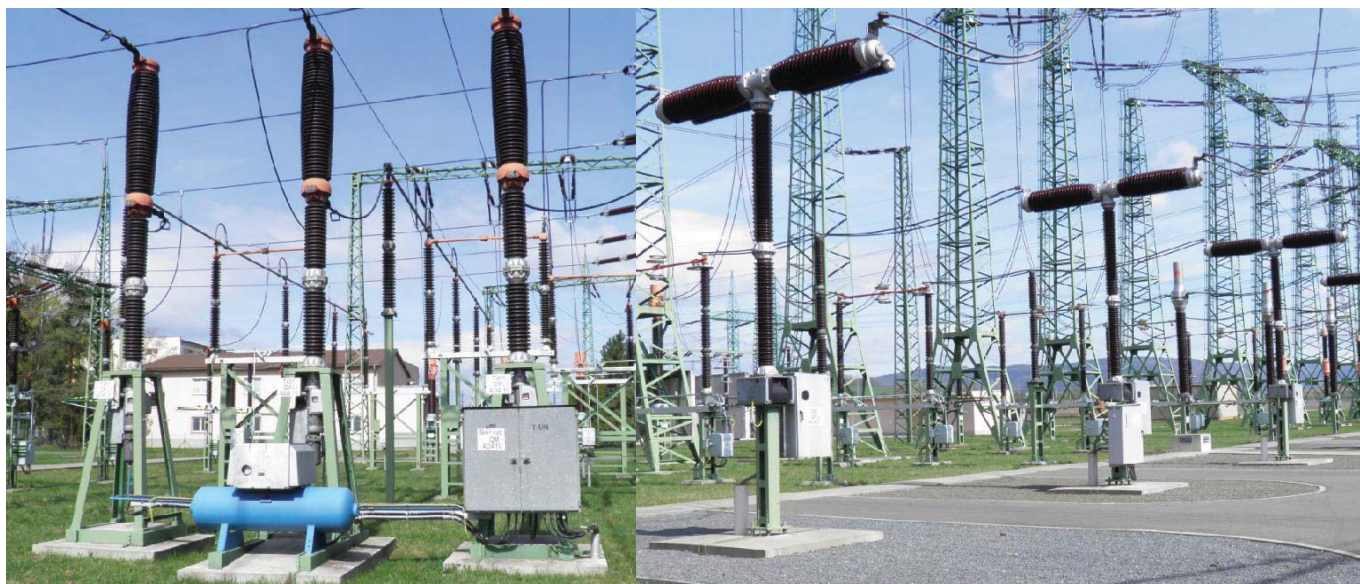
Obr.14a: Vypínač 220 kV.
