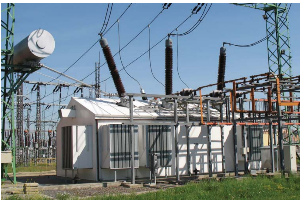
Obr. 16: Ukázka transformátoru 400/110 kV v rozvodně Nošovicích.
